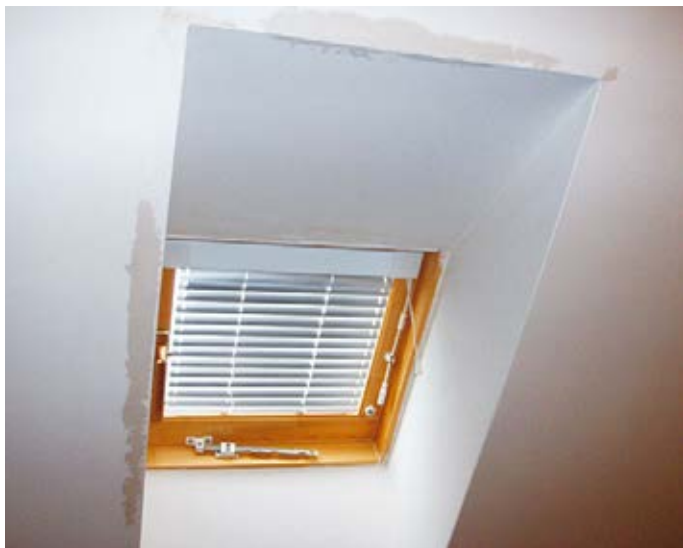
Obrázok 3: Strešné okno so zatečením po nesprávnej montáži
